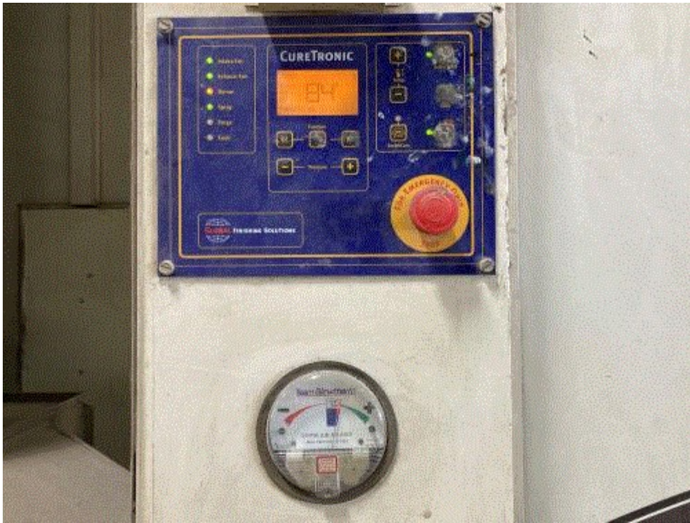
Image 2(IMG 0416) : EUBOOTH1 control panel.
